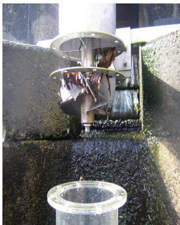
▲塵芥の堆積の様子
