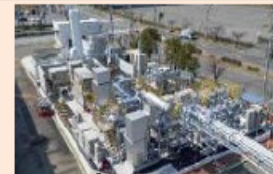
神戸市のポートアイランドに整備された 水素発電施設（水素CGS）
