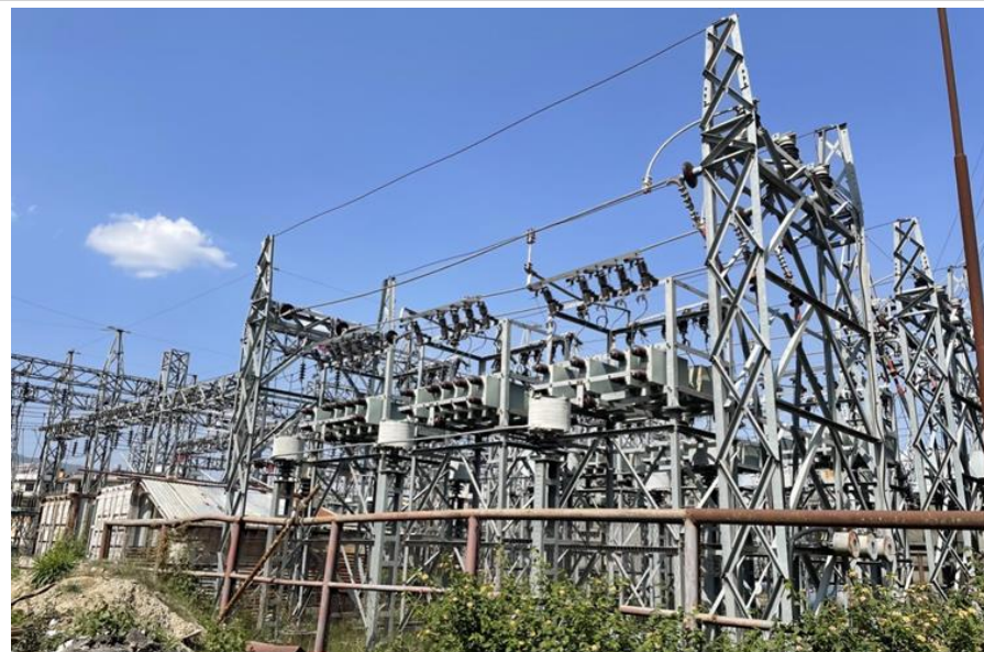
カトマンズ市内の既存の変電所
